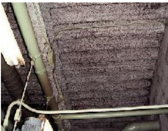
石綿含有吹付けロックウール
