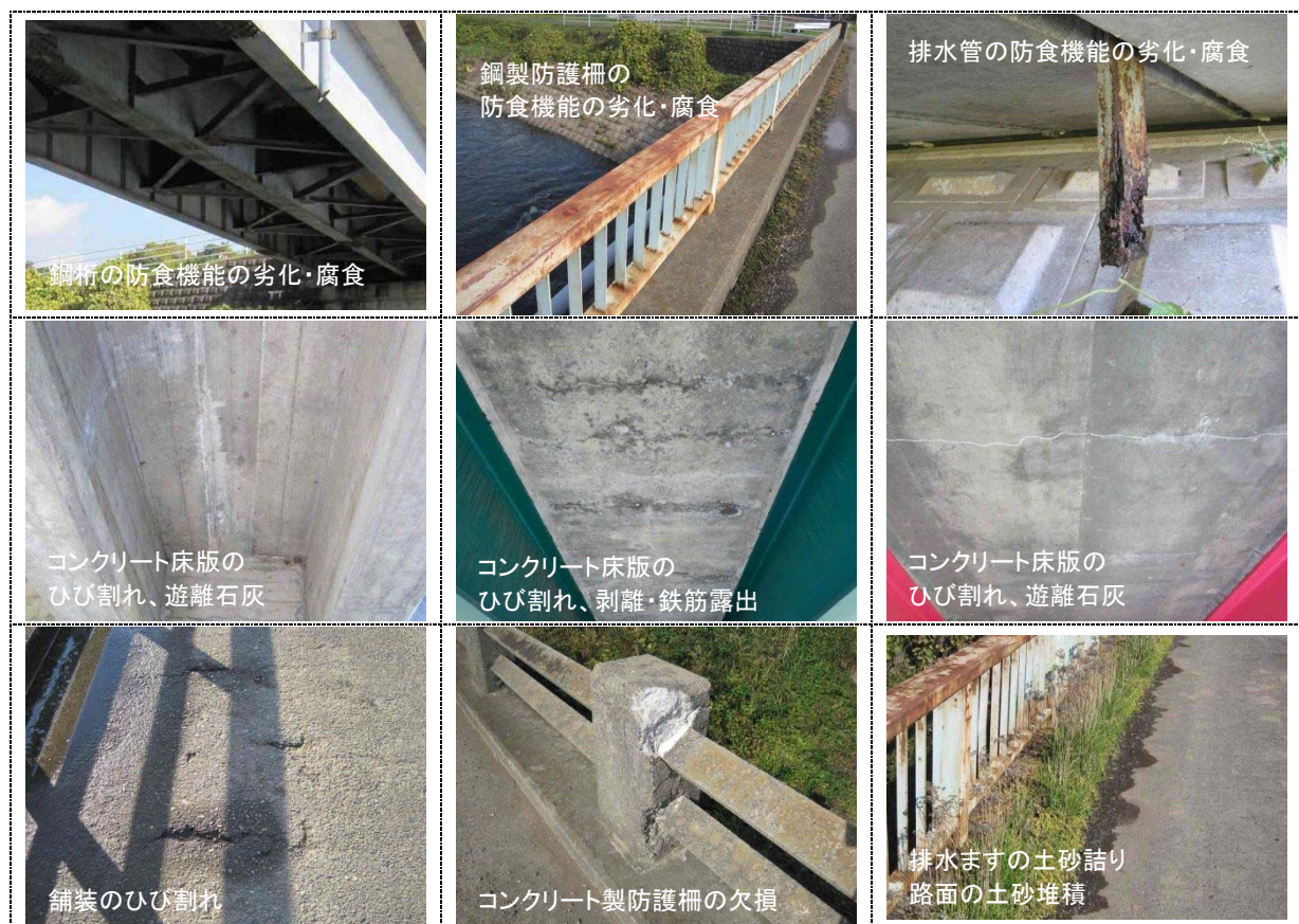
図 3-6 H23 年度の橋りょう点検で見えられた変状例
