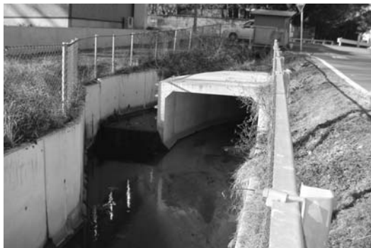
浸水対策下水道排水口 (間の田地区)
