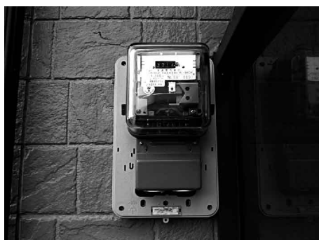
電気メーター
